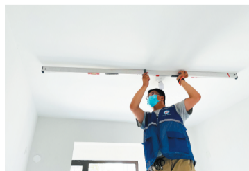
顶面局部不平整，偏差约15毫米。
