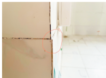
卫生间墙面瓷砖局部铺贴不平。
