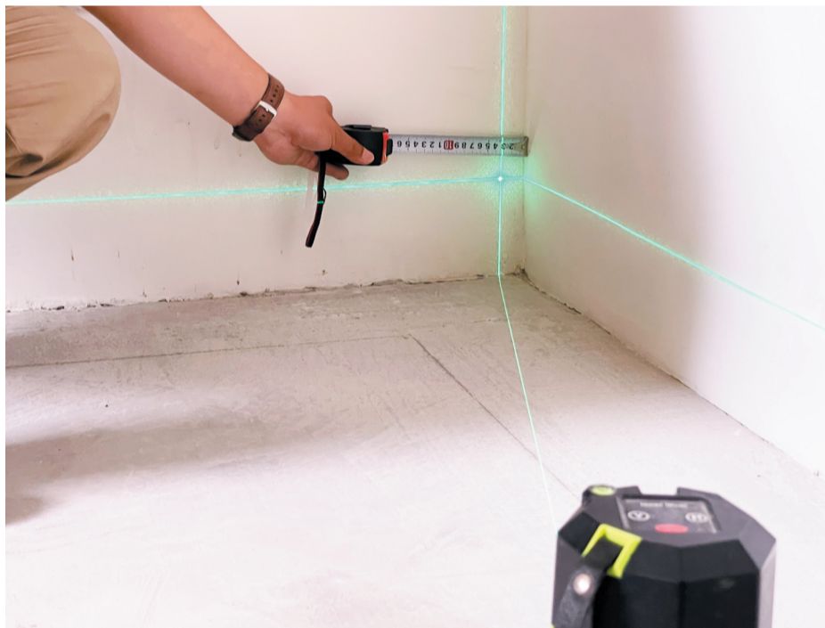
此处墙面阴角不顺直，偏差较大。
