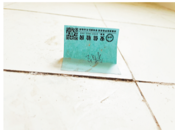
这套房卫生间和厨房多处地砖铺贴不平。
