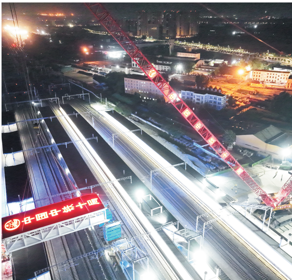
6月9日深夜,淄博站客运设施改造工程旅客天桥和市政天桥,跨站内吊装作业拉开帷幕。
