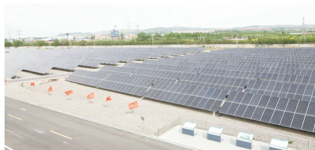
齐鲁石化光伏发电项目 通讯员 刘芳芳
