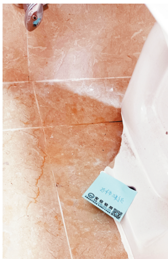
马桶底座破损。
