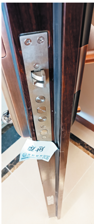
门扇框有磕碰变形。
