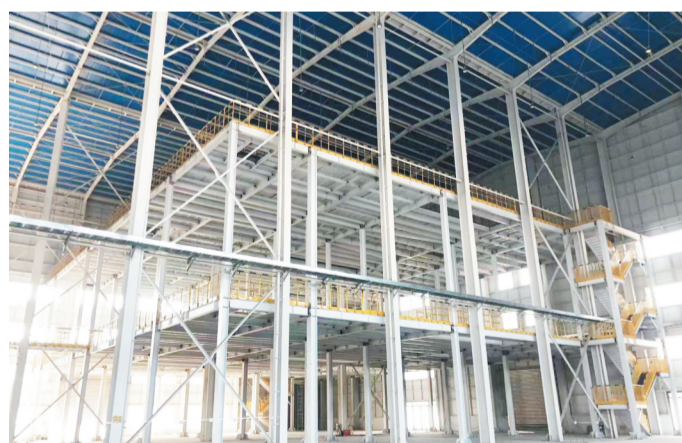
预填式中空玻璃不锈钢间隔条生产车间
