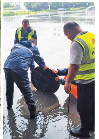
桓台县综合行政执法局工作人员在易积水点位疏通排水。
