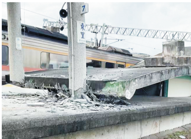
花莲东里车站雨棚被震垮。
