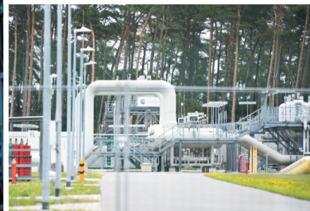
这是9月14日在德国卢布明拍摄的“北溪-1”天然气管道相关设施。
