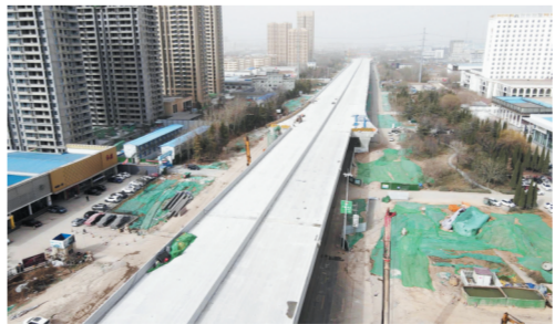
4月7日 淄博快速路金晶大道段桥面主体除沥青铺装及交安设施外基本完成。
