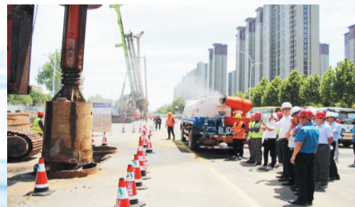
5月18日 淄博市城市快速路网一期工程首件桩基开钻仪式在鲁泰大道项目现场举行。
