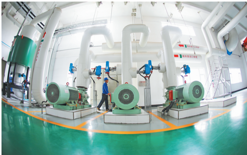
供热首站设备巡检。
