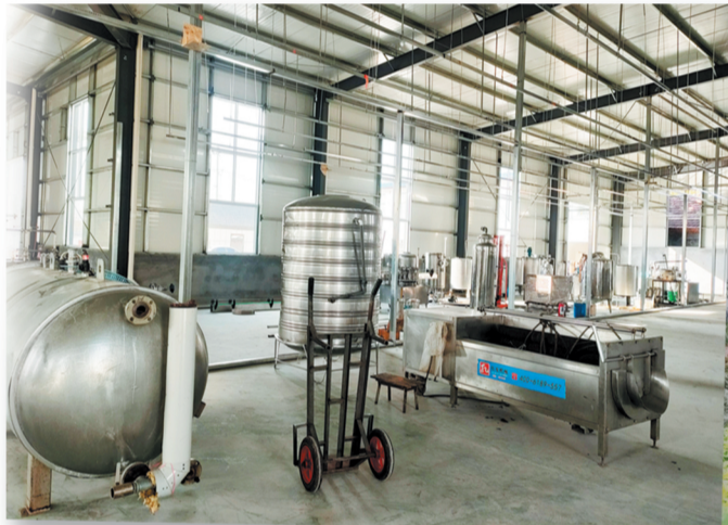
大薄村莲藕深加工车间,待安装的生产线设备。
