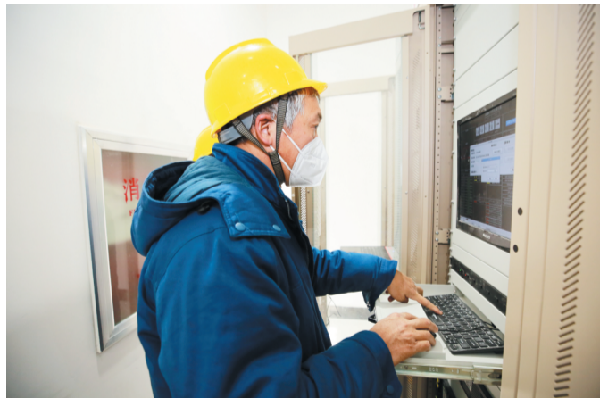
变电运维人员正在调试验收变电站内设备。
