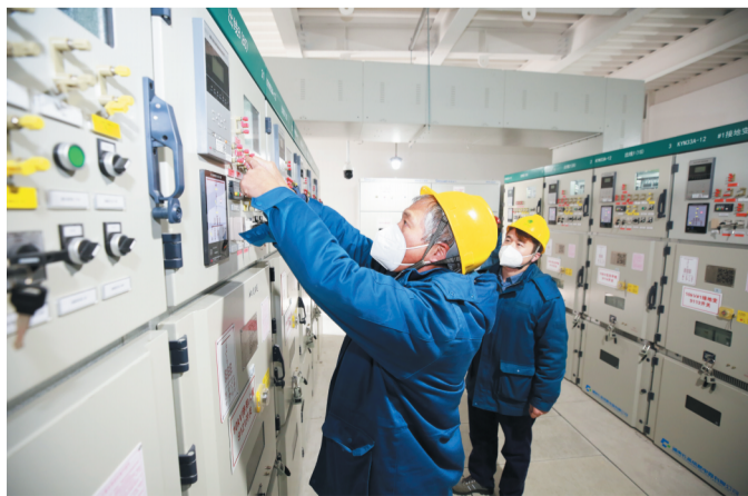
变电运维人员正在进行送电操作。
