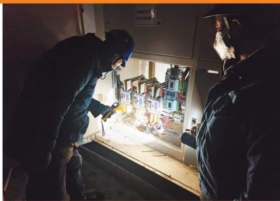
卜海乐和同事夜间对小区环网柜进行测温。
