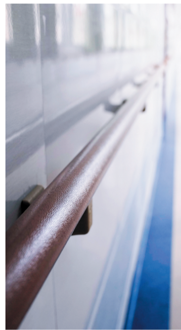
临淄区养老中心第二康复养老院走廊上人性化设计的扶杆。
