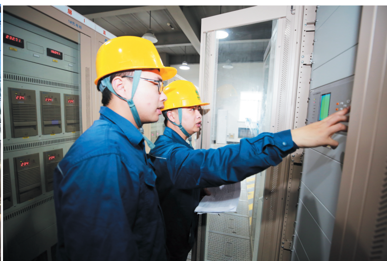
变电运维人员正在做投运前的最后准备。
