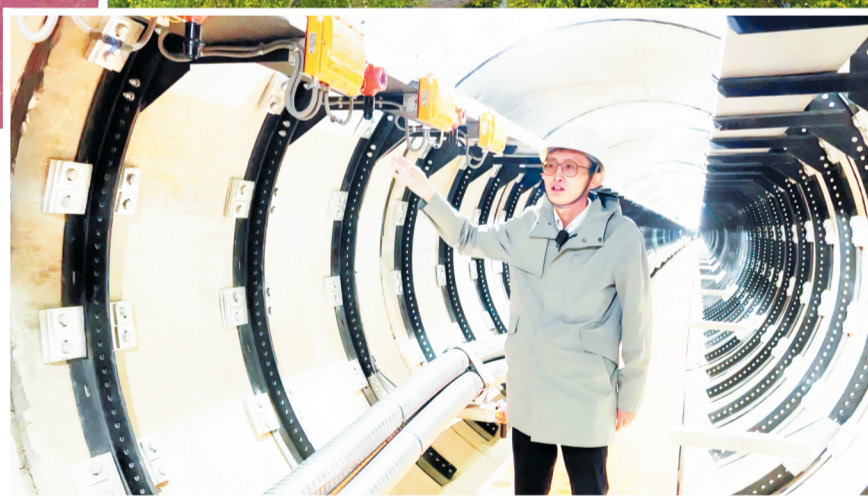
中润大道地下综合管廊内干净整洁、灯火通明,管线排列井然有序。
