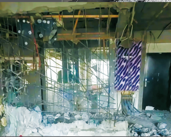
3楼装 修承重墙被 砸。
