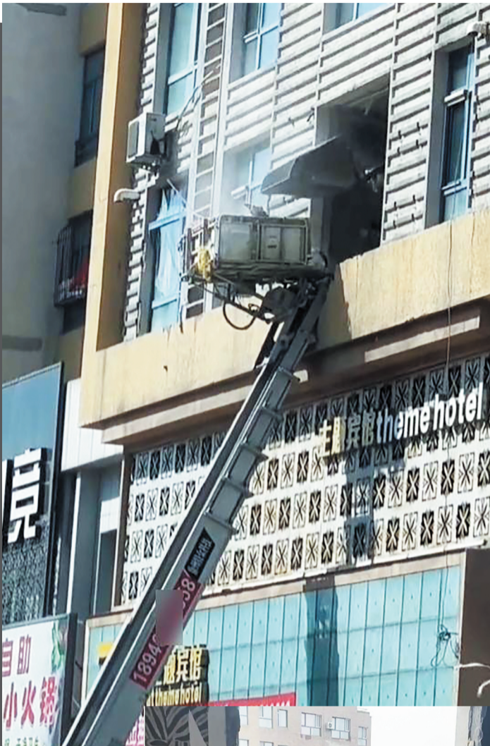
3楼装修 砸穿承重墙。
