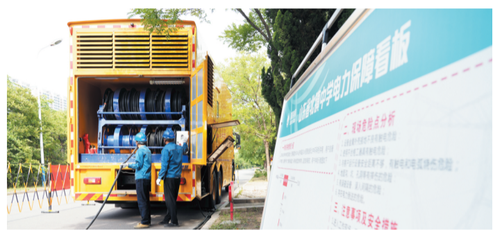
供电公司工作人员释放应急电源车的电缆。
