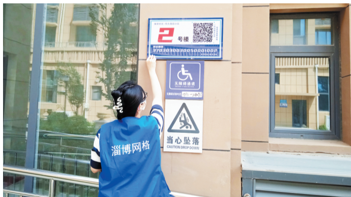
小区安装了智慧门牌，便于有针对性地为居民提供服务。
