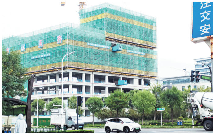
位于新村路与天津路路口的淄博市公共卫生中心建设项目施工现场
