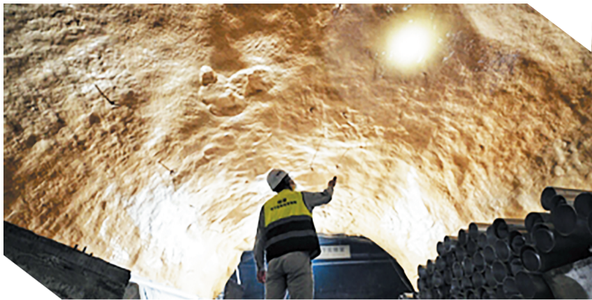
锦屏地下实验室二期,岩壁采用防水抑氦材料,图为工作人员正在检查岩壁。
