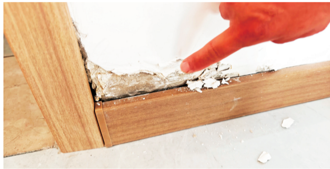
房屋墙面因地暖漏水受损。
