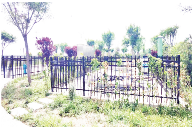
上海路污水提升泵站全貌
