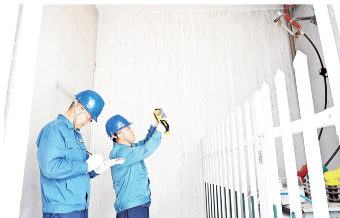
电力工作人员在测温。
